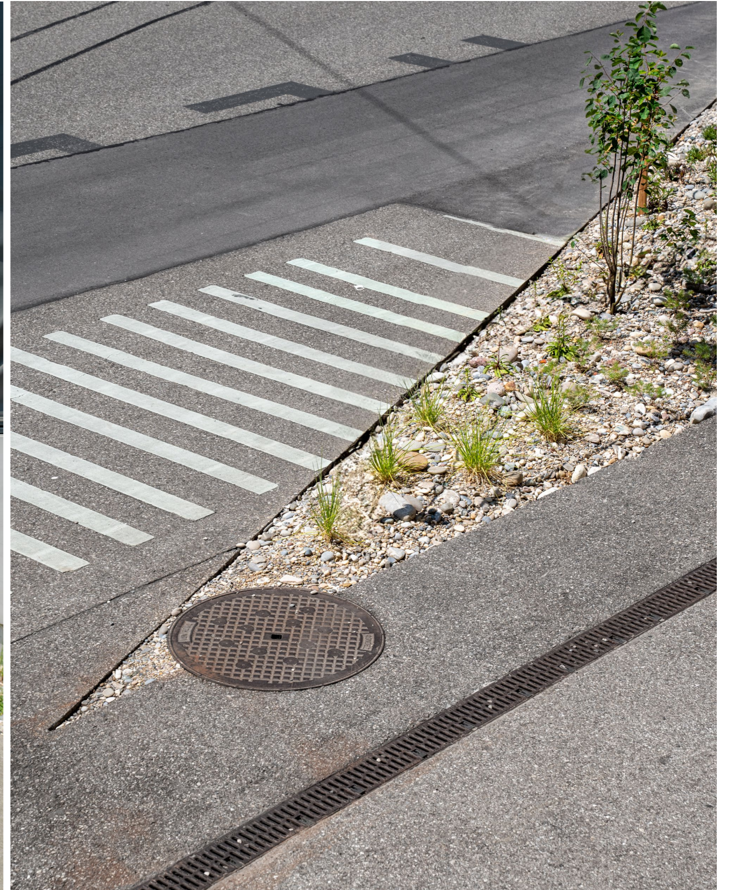
Asphaltbeschnitt ohne Berücksichtigung der bestehenden Struktur
